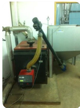
Caldeira edifício administrativo (Biomassa)
