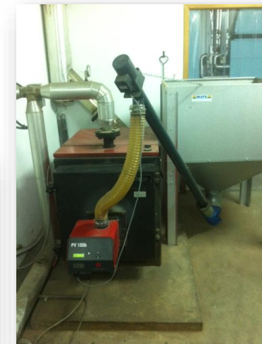
Caldeira edifício administrativo (Biomassa)
