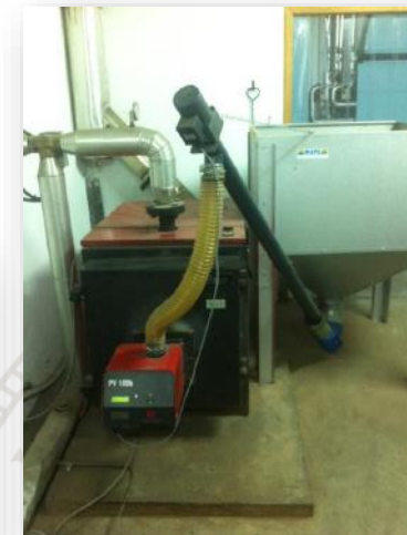
Caldeira edifício administrativo (Biomassa)
