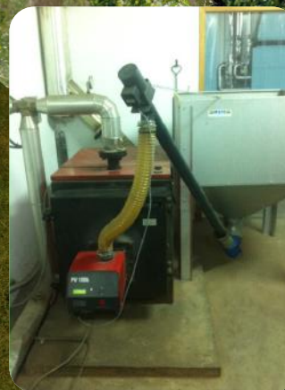
Caldeira edifício administrativo (Biomassa)
